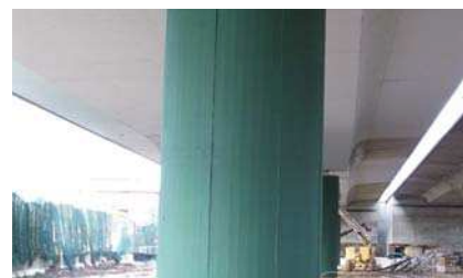
Правило 9, метод 9.1 Покрытие Masterseal наносится непосредственно на бетон для защиты основного армирования.
