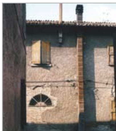
Рис. 5.3 Стена с поднимающейся влагой
